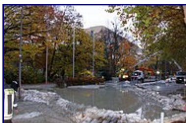
Aufgefangene Wasser- und Betonschlammmassen
